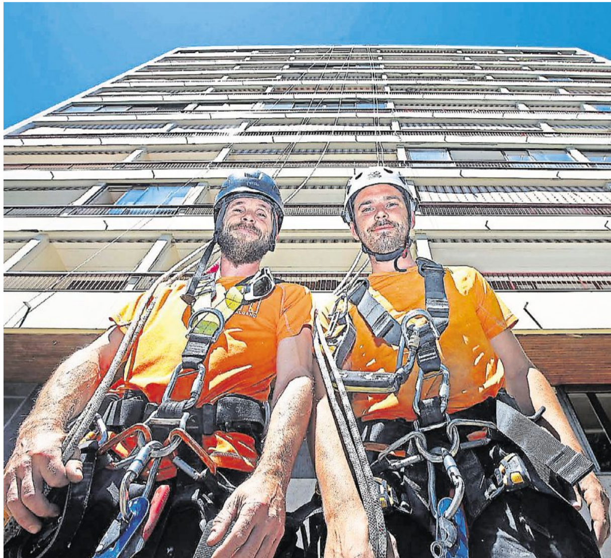
Le Mans, vendredi dernier. Yann Halgand et Fabien Poivet en pleine intervention sur cet immeuble de onze étages. Ils se rendront bientôt à Orléans, pour des travaux sur une clinique. Photo - Le Maine Libre - Olivier Blin.
